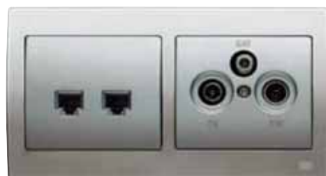
Entrada de teléfono + entrada de antena
